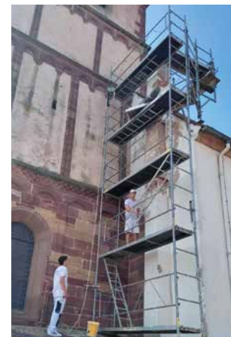
Travaux de rénovation de la cheminée et du toit de la chaufferie de l'église de Willgottheim
