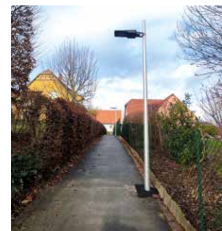
Installation de lampadaires solaires le long de l'accès piéton reliant la rue de la Mésange à la rue des Serruriers
