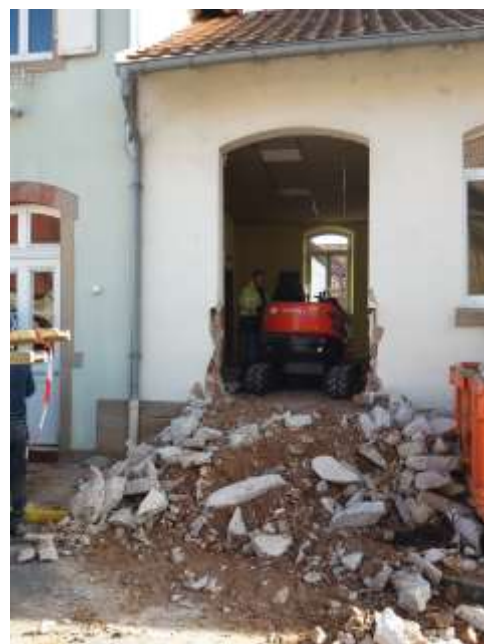
Démarrage du gros-œuvre : Déplacement entrée principale et abaissement du sol pour entrée et rez-de- chaussée de plain-pied
